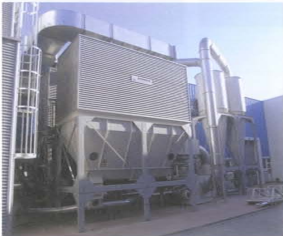
Absaugsystem mit Abscheide-Filteranlage für Fräsabfälle. Krämer Lufttechnik bedient mit seinen Systemen unter anderem die Druck-, Verpackungs-, Kunststoff-, Lebensmittel- und Holzindustrie.
