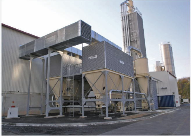
Rückführung der gereinigten Prozessluft.
