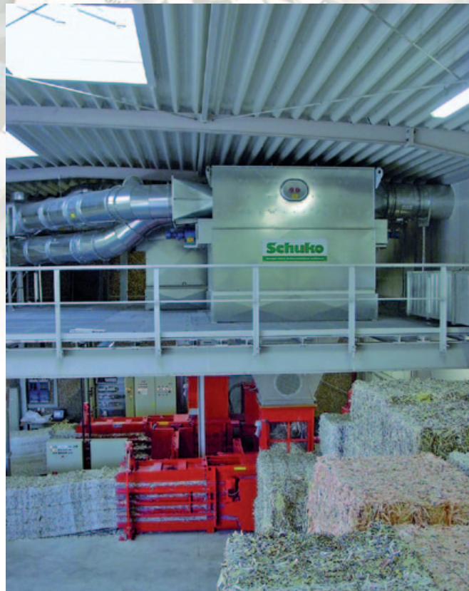
SCHUKO: Absauganlage mit Ballenpresse.
