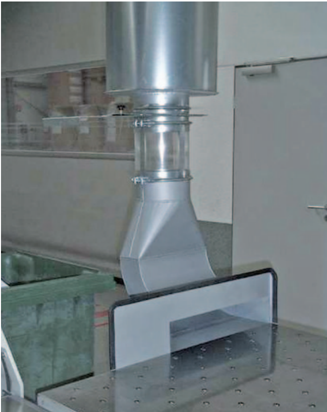
Stoll: Absaugung an einem Planschneider.
